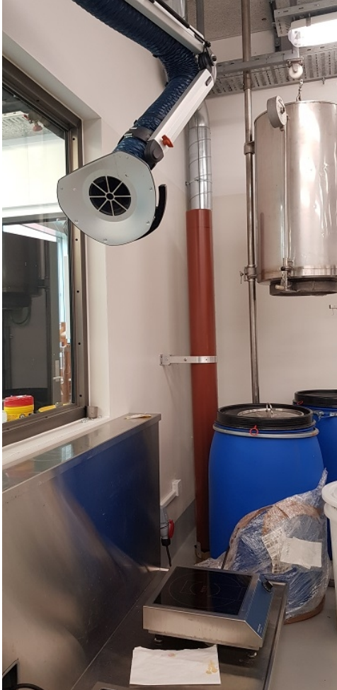
Bilde 6. Fargeri. Store kjeler plasseres på kokeplater for dampvask. Punktavsug plasseres over kjelene.
