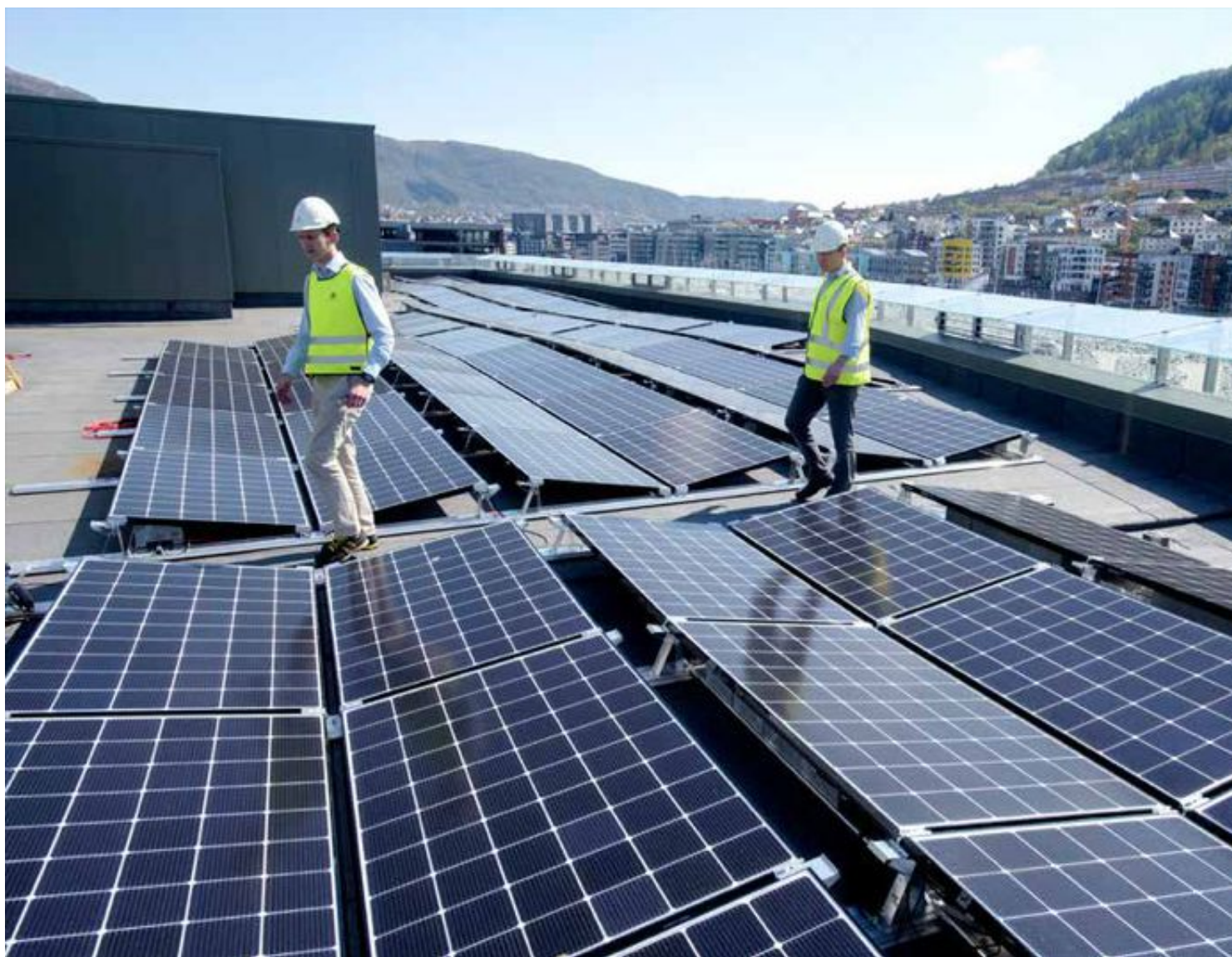
SOL UTE, STRØM INNE: 460 solcellepaneler er plassert på taket av nybygget Basen på Marineholmen. – Vi har lyst å teste ut det som blir en viktig del av energifremtiden, sier prosjektdirektør Gunnar Hernborg (til v.) og administrerende direktør Tor Instanes i GC Rieber Eiendom.
