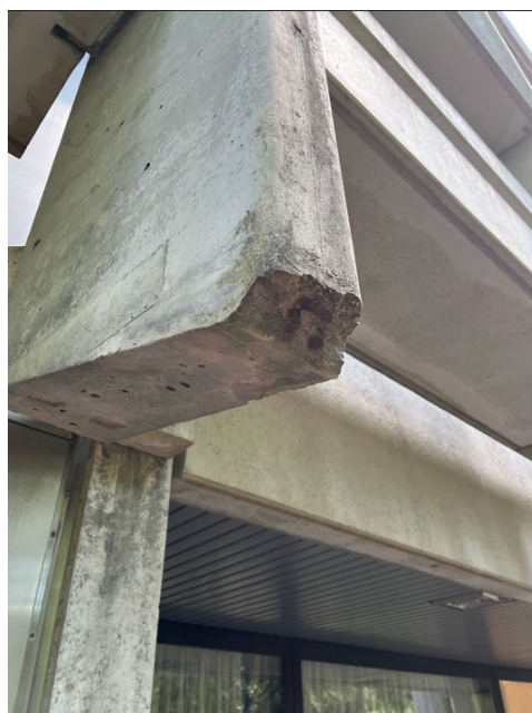
Figur 9 Betongbiter faller ned fra rasteret i den vernede fasaden
