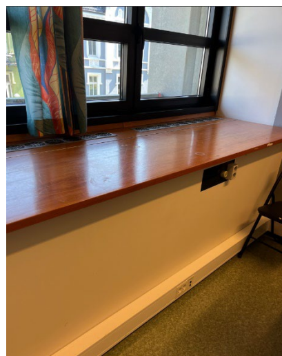
Figur 8 Konvektorkasser under vinduene i Realfagbygget
