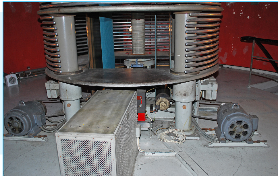
Fundament og motorer ved generatorfoten. Foto: EIA
