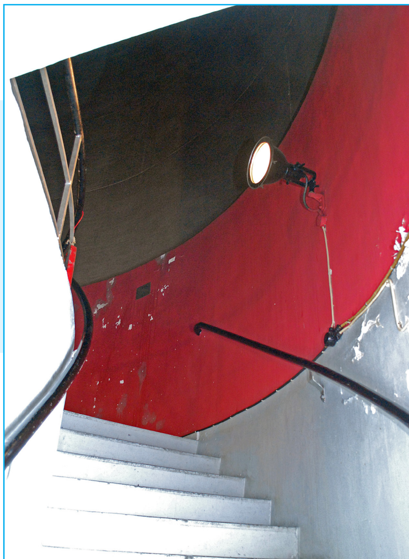
Trapp opp til generatorrom med rødmalt betongvegg under ståltank av skipsstål. Foto: EIA
