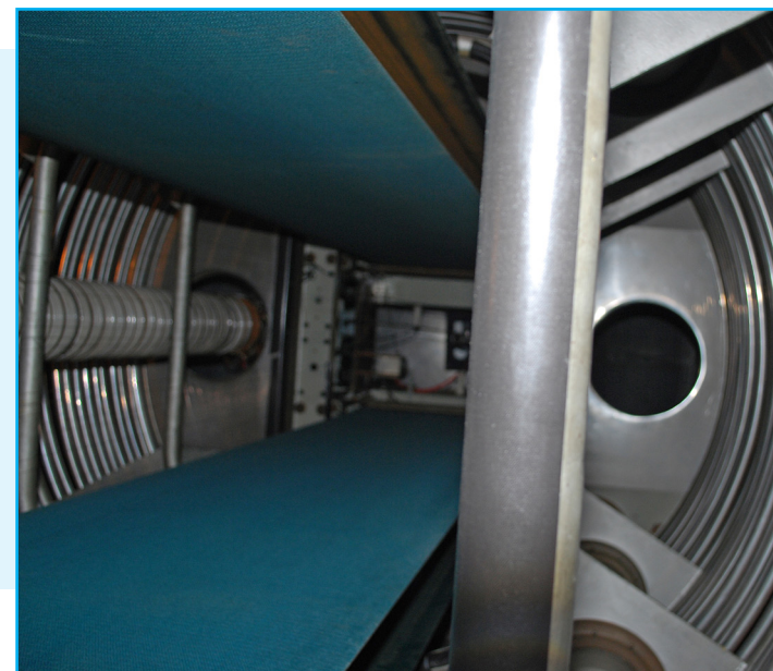
Inne i generatoren, sett oppover med keramisk søyle lengst til venstre, fiberbåndet, hullet operatøren må krype gjennom og veven av aluminiumsrør til høyre.
